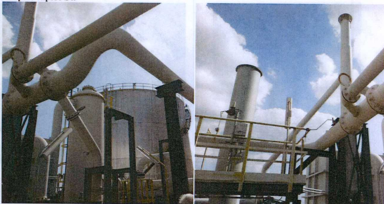
Figura 8 Particolare del collegamento delle tubazioni all'impianto di recupero vapore S4.
