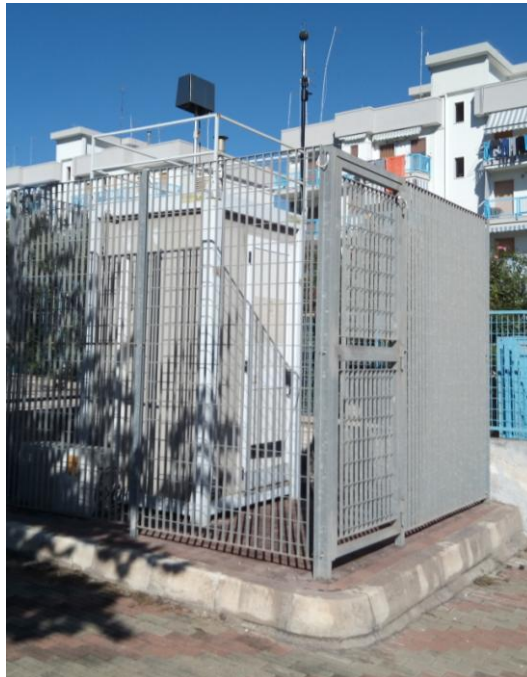
Figura 4.2 – Rilievo eseguito sulla centralina della qualità dell'aria in via Ancona
