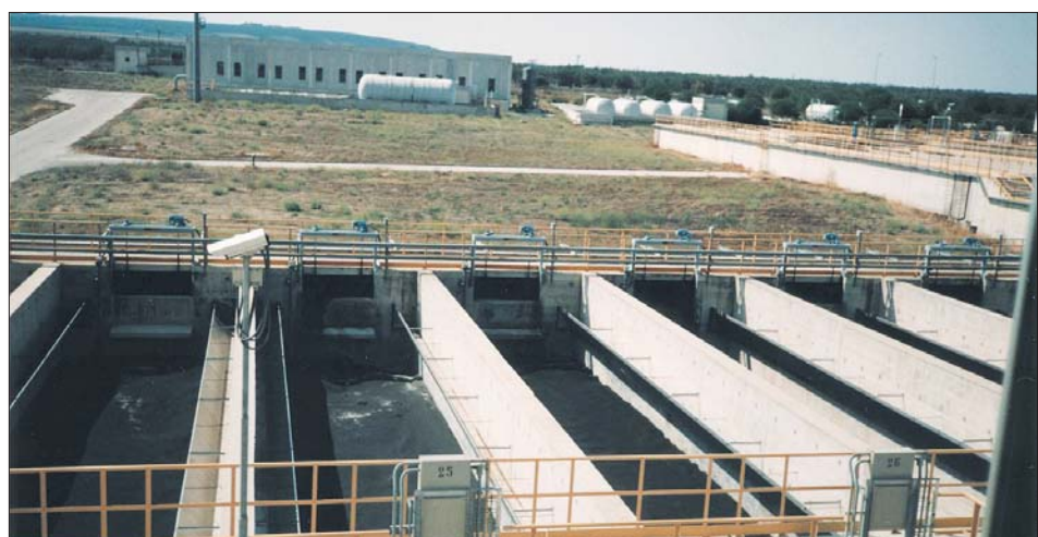
Foto 2.1 L'impianto di potabilizzazione del Locone (BA)
