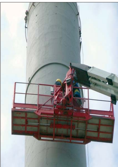
Fig 1.12 Installazione della sonda al punto di prelievo fumi
