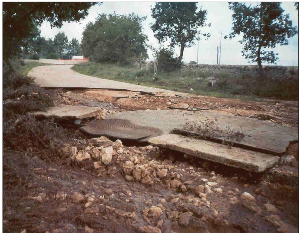
Foto 4.3 Cassano delle Murge, Strada dissestata a seguito dell'alluvione del 22 ottobre 2005
