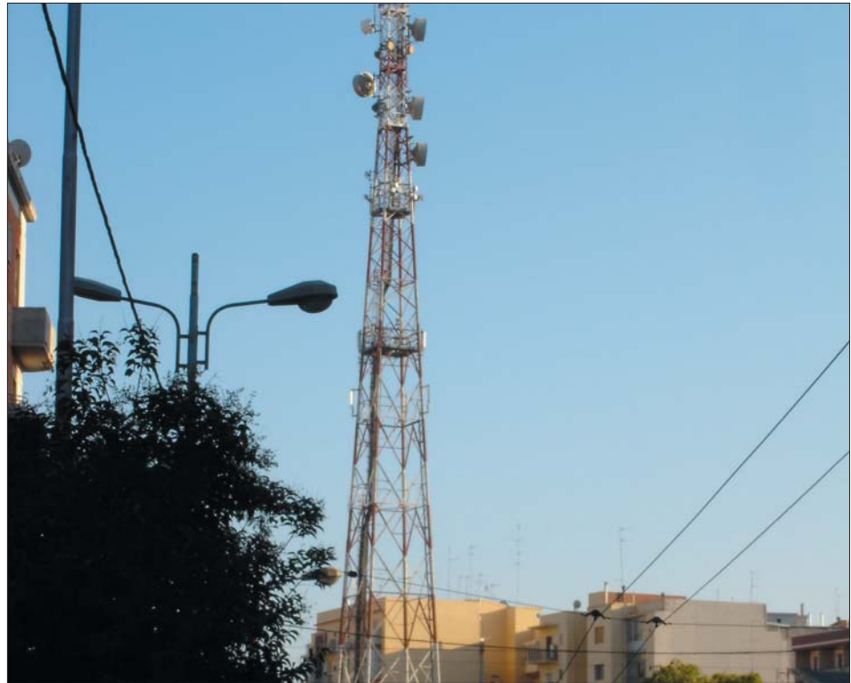
Foto 7.1 Stazione Radio Base
