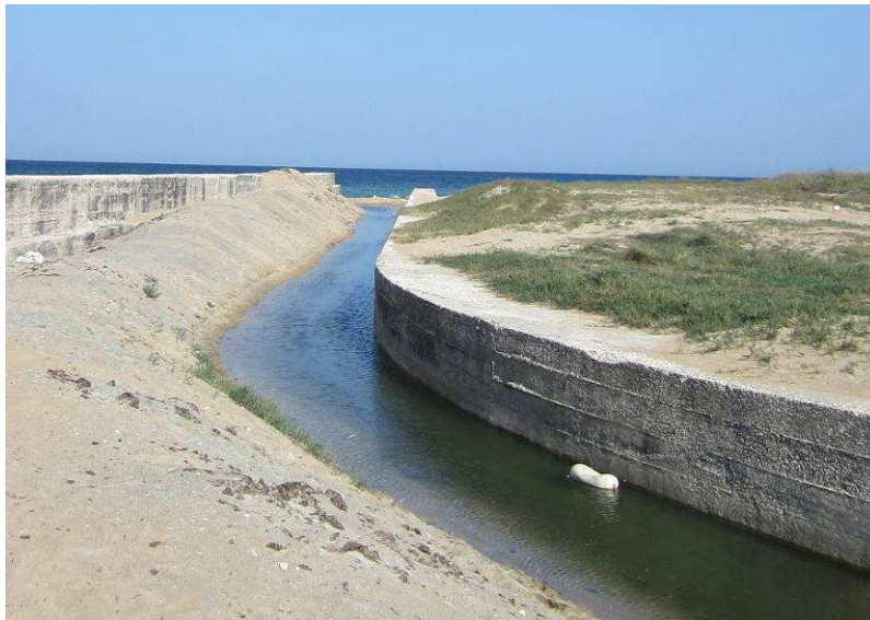
Fig. 61. Uno dei canali di comunicazione tra la laguna di Acquatina ed il mare.
